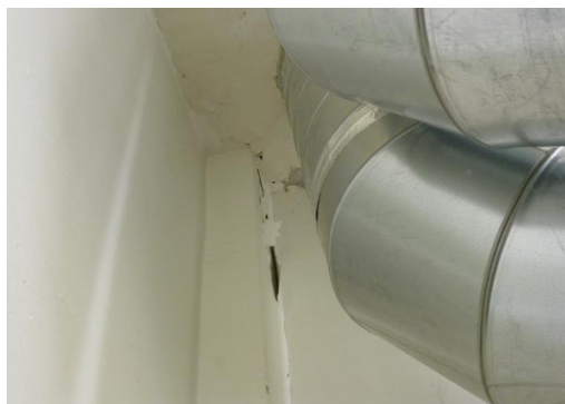
Fig., 7 : Traces d'humidité.
