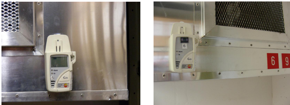
Figure 4 : Enregistreurs positionnés sur une bouche de soufflage et d'aspiration
