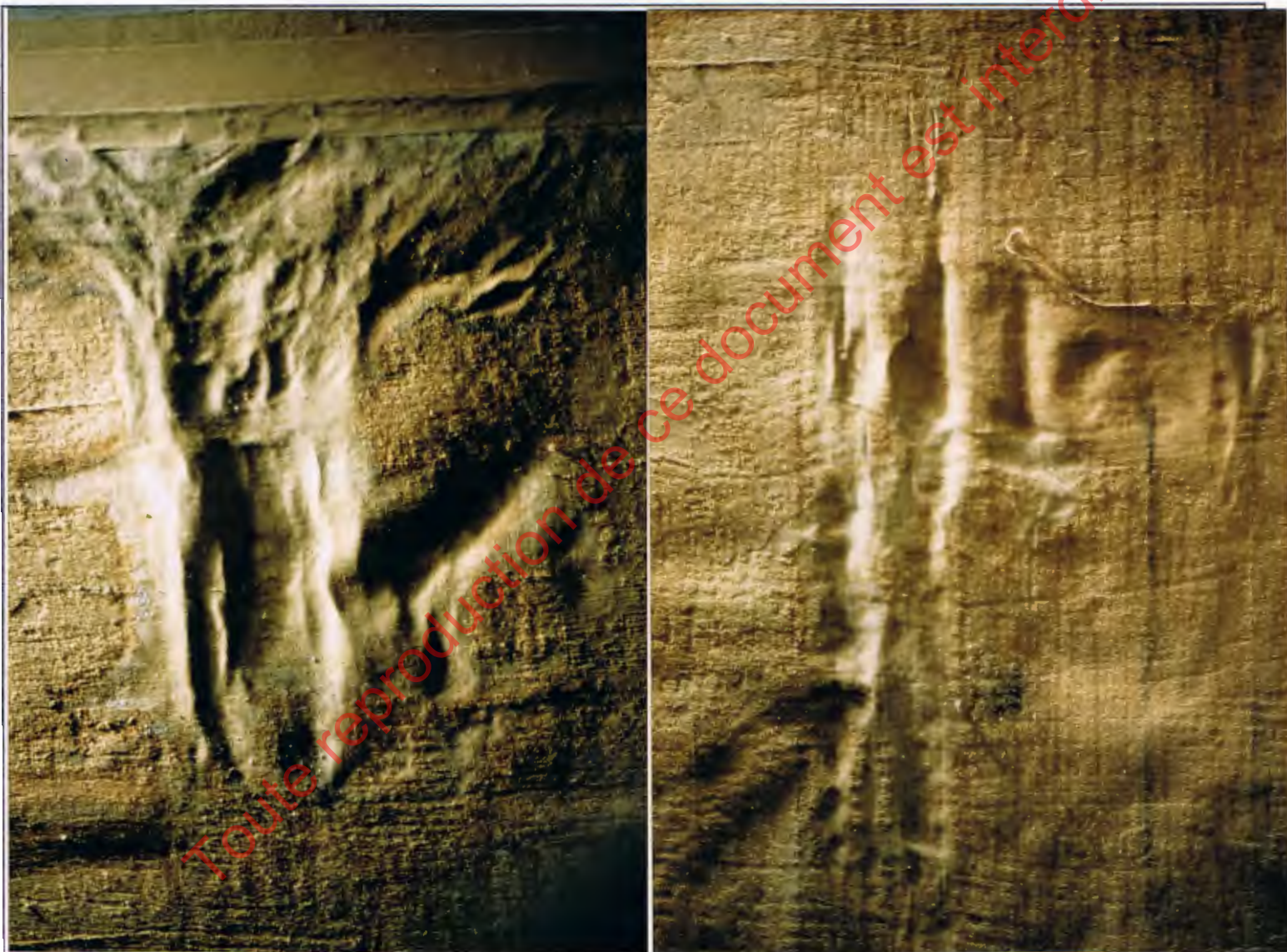
Figure 11 et 12: Cloques et boursouflures vues du revers
