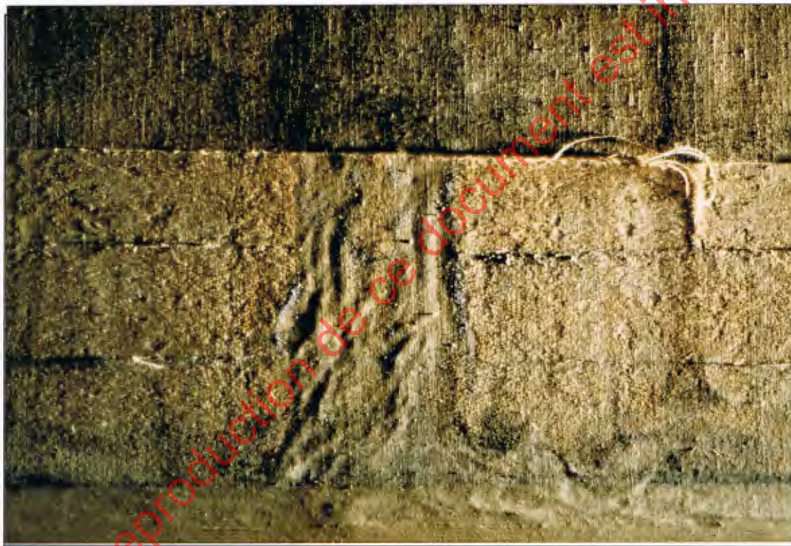
Figure 2: Décollement des deux toiles
